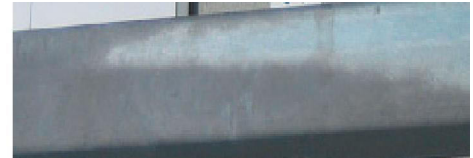
Der kan forekomme farveskifte på overfladen, men den påvirker ikke kvaliteten af korrosionsbeskyttelsen. Dette skyldes, at reaktionen mellem zink og jern sker med forskellig hastighed afhængigt af ståltypen, samt afkølingsforløbet efter forzinkningen.
